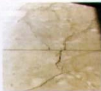
Fig. 2a Fessurazione da ritiro plastico
