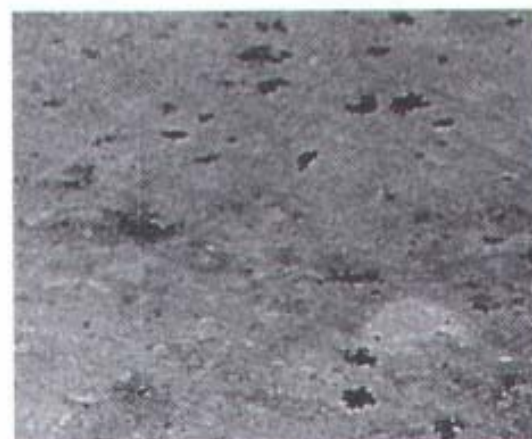
Fig. 9 Macchie sul pavimento
