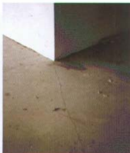
Fig. 5 Fessura lineare dovuta alla mancanza di un giunto di isolamento del pilastro
