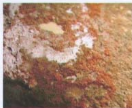
Fig. 7a Formazione di bolle in una pavimentazione rivestita in resina Fig. 7b Gel costituito da silicati alcalini che inizia a essiccarsi e ad assumere un aspetto farinoso
