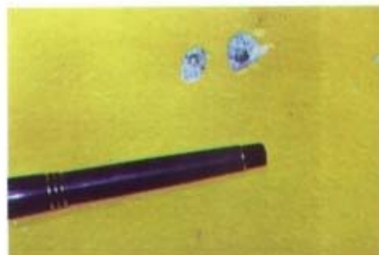
Fig. 8 "Pop-out" su pavimento in calcestruzzo resinato
