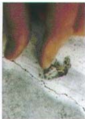
Fig. 11 Fascetti di fibre al di sotto di un "pop-out"
