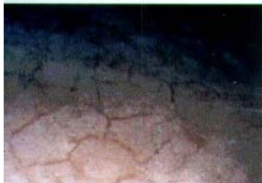
Fig. 3 Fessurazione: cavillature a carta geografica
